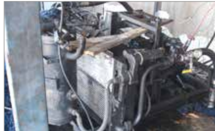
Imagen 1: Estación de aire comprimido descuidada.
