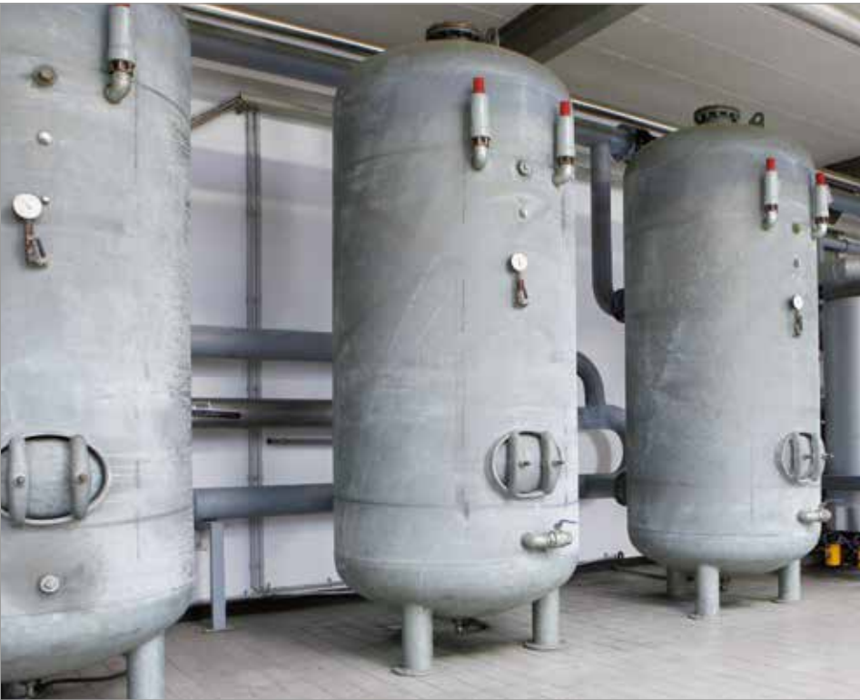
Imagen 4: Depósito de aire comprimido de reserva.
